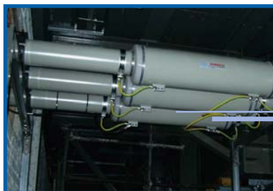
DG 17,5 kV – 2500 A
