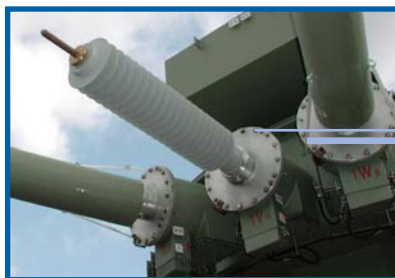
DTOI 123 kV – 1250 A
